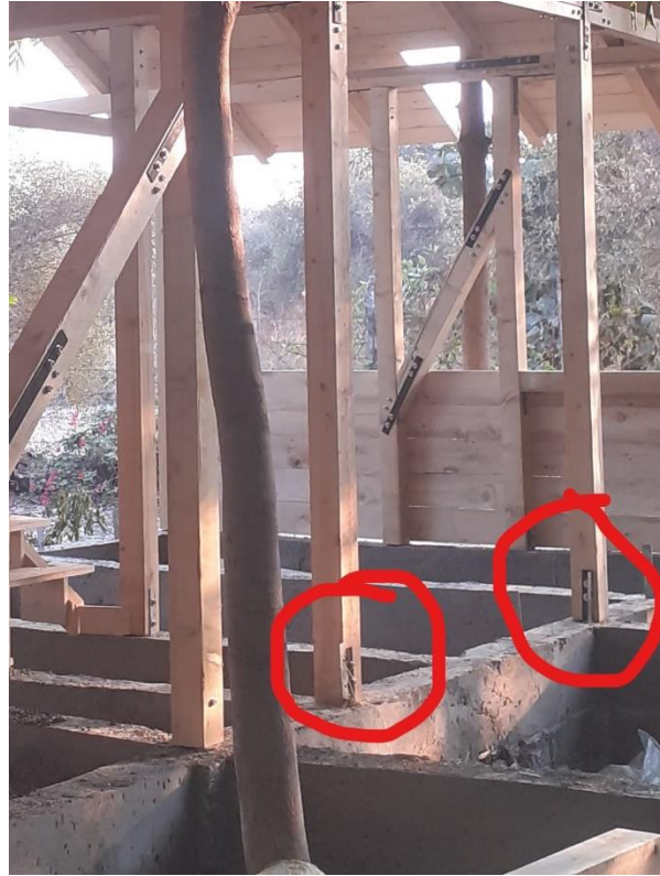
En esta foto la orientación de los ángulos de solera es opuesto.
